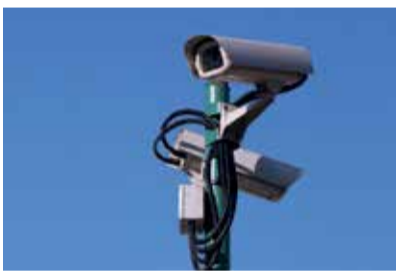
Impianto di videosorveglianza (particolare)
