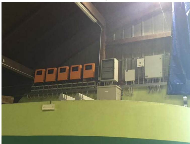
Veduta componenti elettriche relative a impianto fotovoltaico (inverter)
